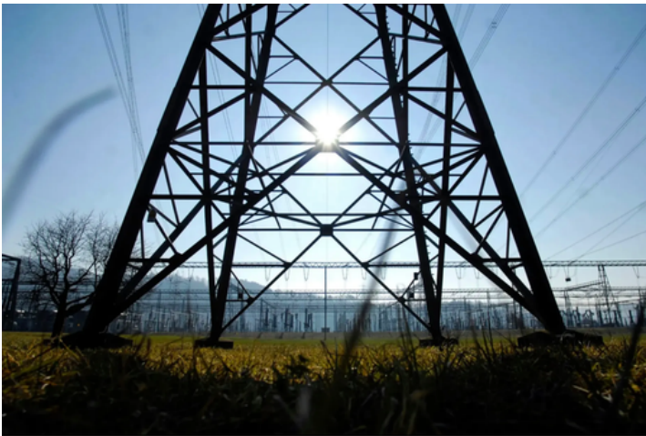
Das grösste Schweizer Umspannwerk: Der von Swissgrid betriebene Stern von Laufenburg AG. Foto: Adrian Moser
